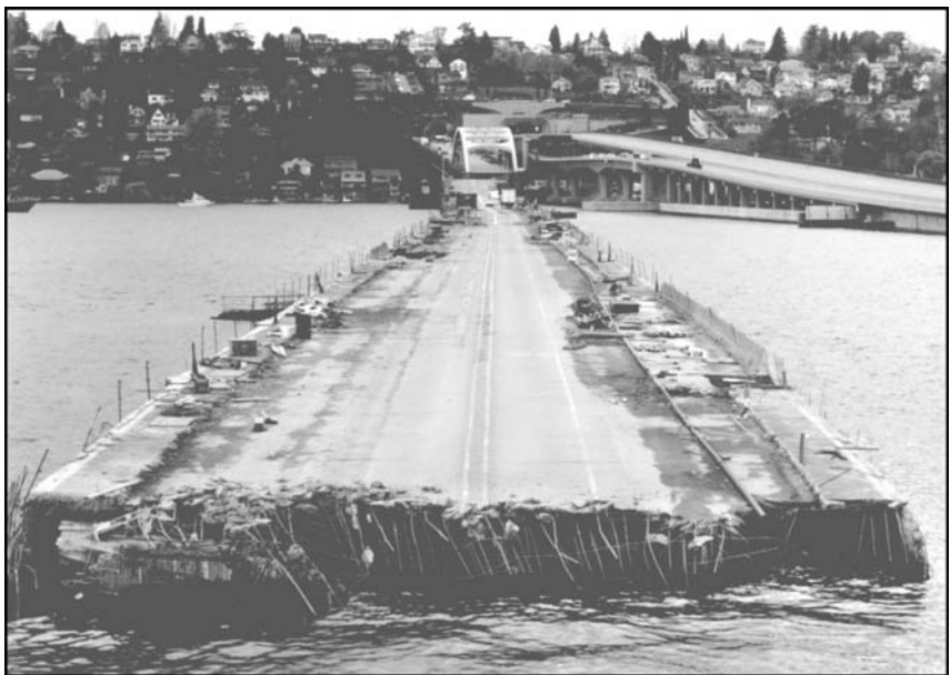
Rysunek 8.1. Część pływającego mostu na drodze I-90 w Seattle zatonała w trakcie burzy, ponieważ nie zamknięto pływaków, które utrzymywały go na powierzchni wody. Deszcz zalał je i most stał się zbyt ciężki. W trakcie budowy oprogramowania zabezpieczenie się przed drobiazgami ma większe znaczenie niż się wydaje.
