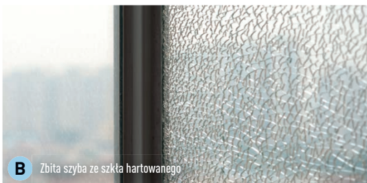
A Pęknięte szkło odprężone (tafla)
